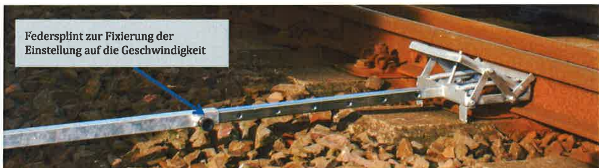
Bild: Schnellspannklemme und Vertikalträger mit geschwindigkeitsabhängiger Verstellmöglichkeit im Bereich der Zungenvorrichtung einer Betonweiche mit der Schienenform UIC60
