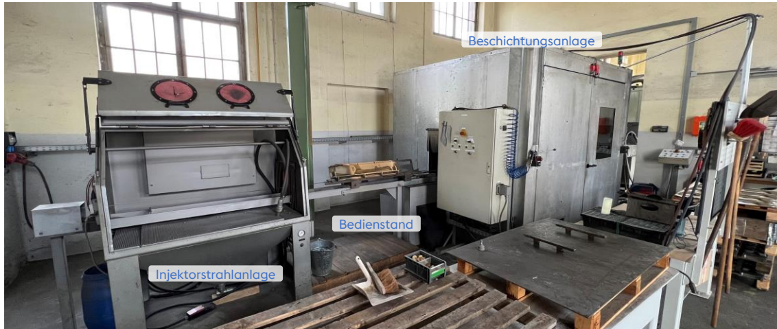
Abbildung 12: Aufbau der vorhandenen Beschichtungsanlage für einzelne Bauteile
